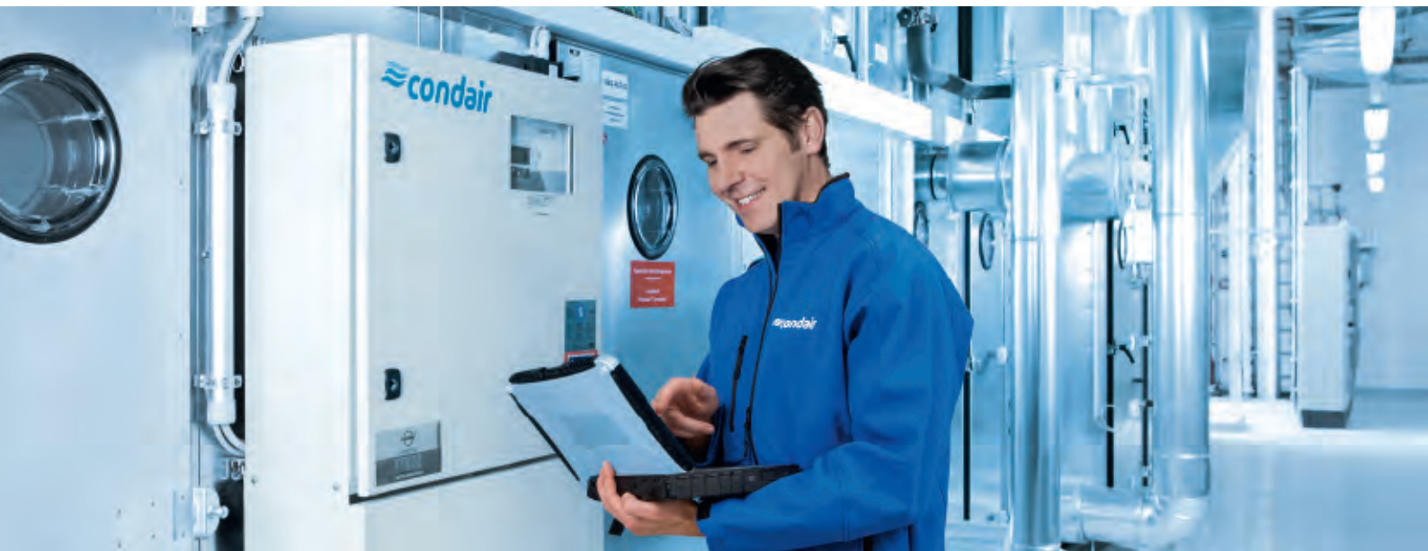
Condair Dual in einer RLT-Anlage
